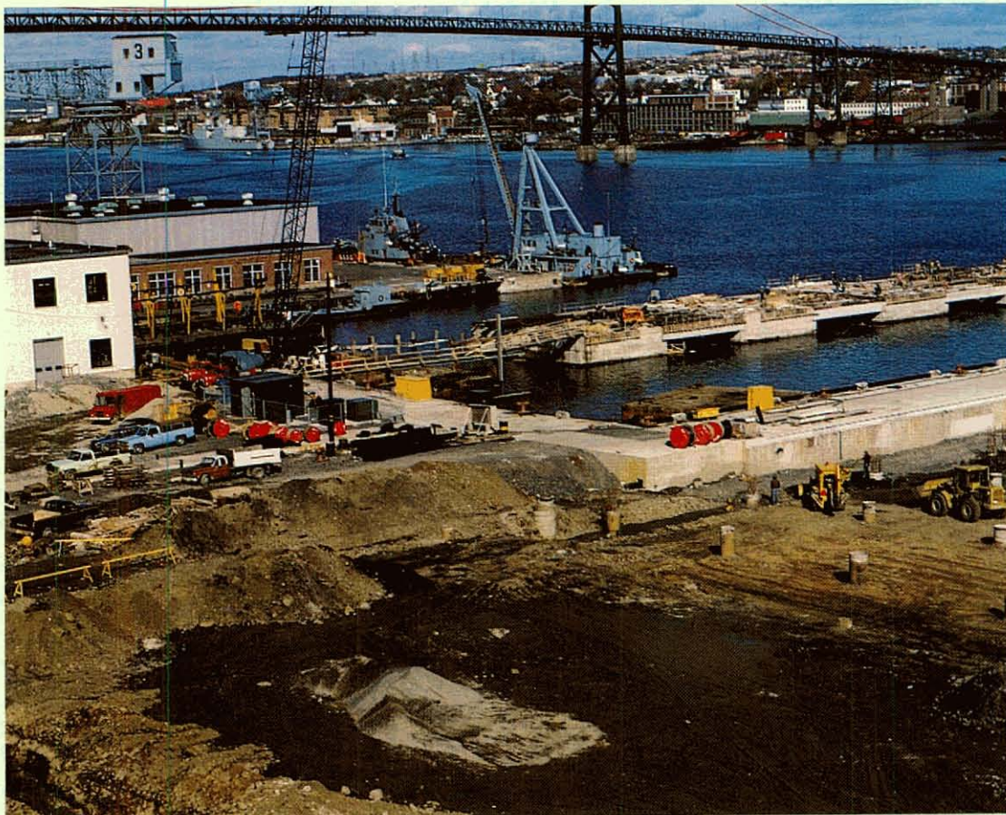
Quai en eau profonde, 520 m de longueur, comprenant 14 caissons de béton, au projet de réparation marine, région atlantique, Halifax, Nouvelle Ecosse.
