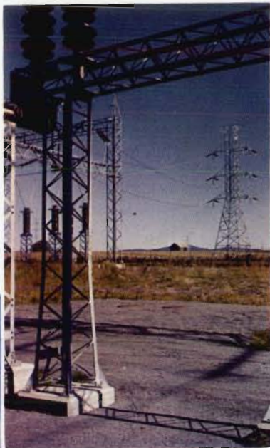
La ligne de Bersimis à l'entrée de la sous-station Charlesbourg, près de Québec . . . The Bersimis transmission line reaching the Charlesbourg Substation near Quebec City . . .
