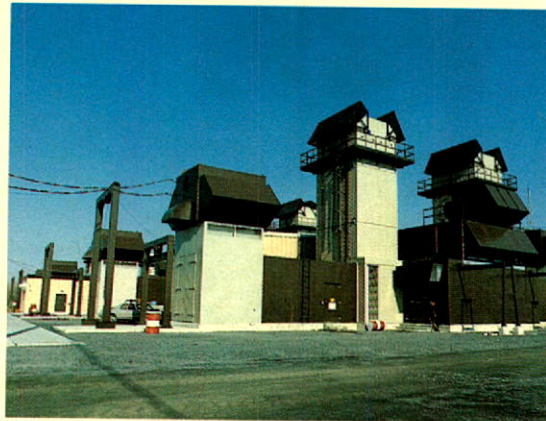
La Citière gas-turbine power station.
