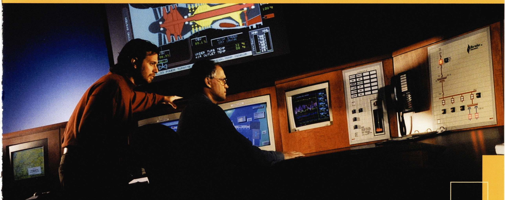
Centre de contrôle de Kingsey Falls
