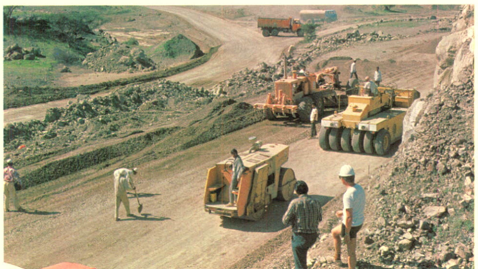
Construction de routes à Oman, comprenant les services de Cansult Limited, Toronto.
