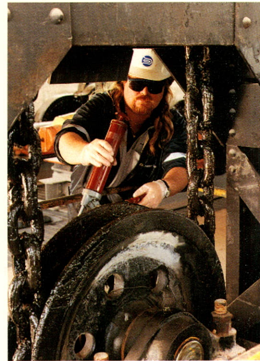
Dave Berry, préposé à l'entretien, graisse les roues qui ouvrent les portes de l'écluse 5 du canal Welland
