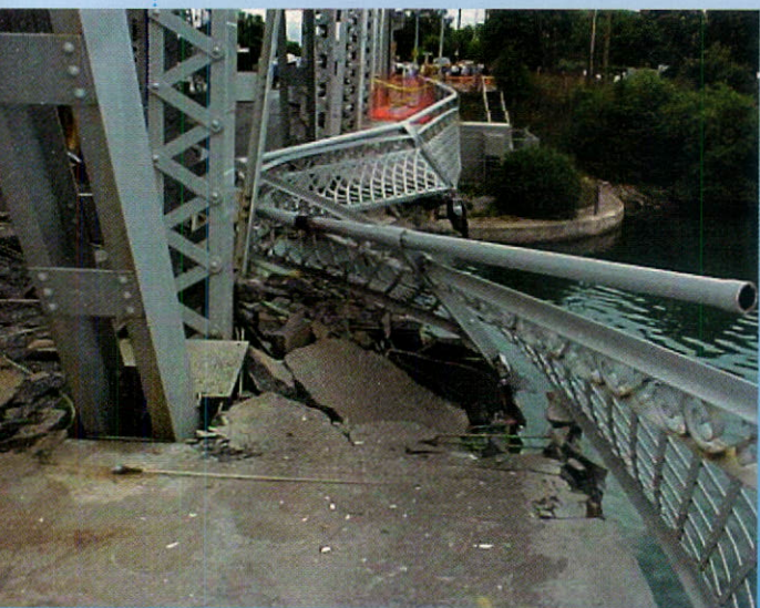
Les dommages subis par le pont 11
