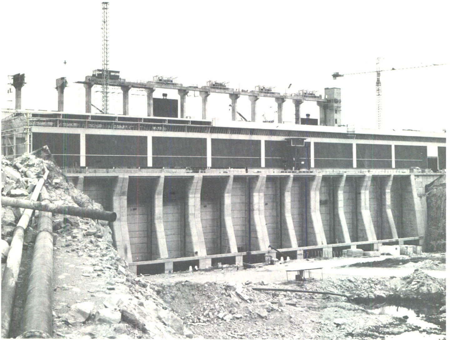
Au Nigeria la Société poursuit les travaux du projet hydro-électrique Jebba d'une capacité de 540 MW. On aperçoit ici la centrale hydro-électrique vue en amont.
