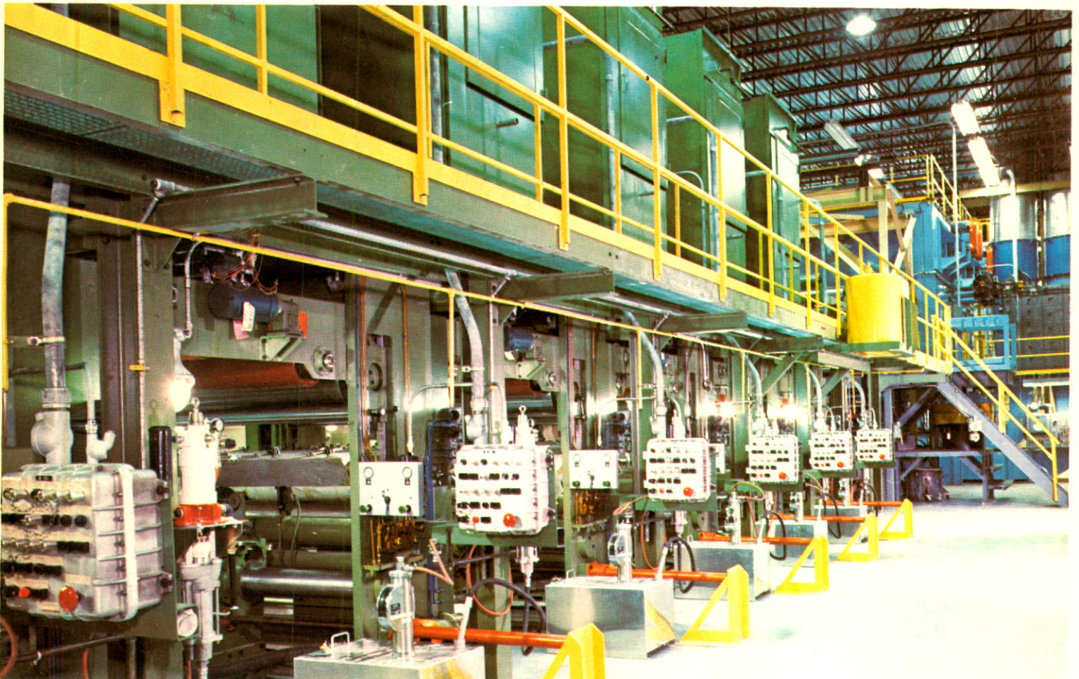
One of the production lines section — Farnham — Section d'une des unités de production.
