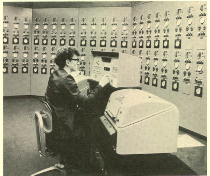
L'une des plus importantes installations parachevées au cours de 1969 est sans contredit la teinturerie automatisée. On voit ici la salle de commande d'où on contrôle le fonctionnement de plus de 60 machines à teinture.
